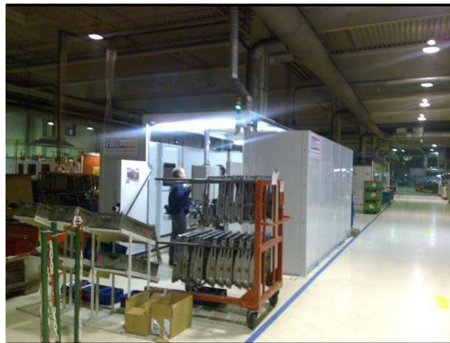
Cabina de soldadura MIG en funcionamiento
